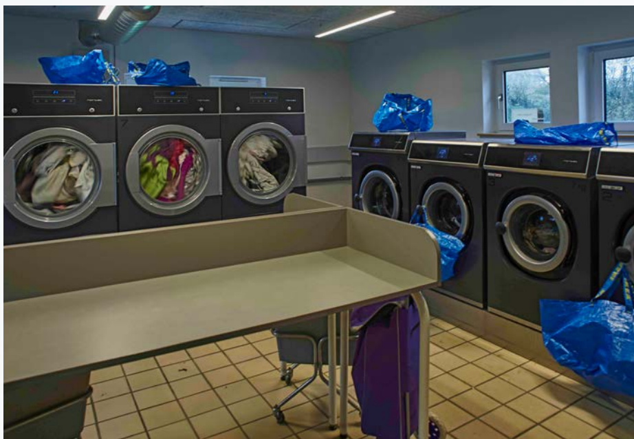
I vaskeriet genanvender man al varmen fra vaskemaskinerne og tørretumblerne.
