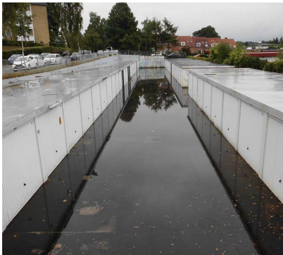
Garagerne i Hans Brogesparken blev oversvømmet ved sensommerens store regnskyl.
